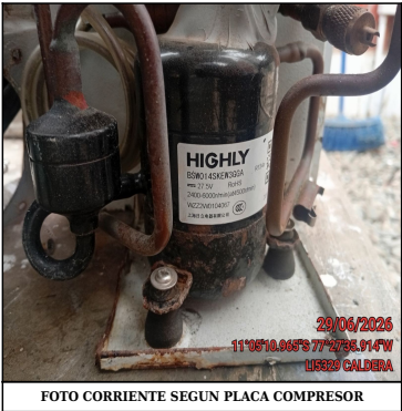
FOTO CORRIENTE SEGUN PLACA COMPRESOR
