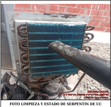
FOTO LIMPIEZA Y ESTADO DE SERPENTIN DE UC
