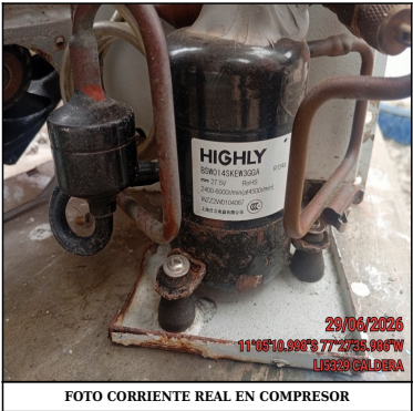
FOTO CORRIENTE REAL EN COMPRESOR
