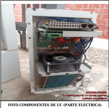
FOTO COMPONENTES DE UC (PARTE ELECTRICA)
