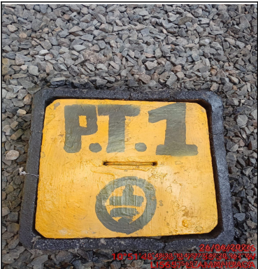
Pozo a tierra
