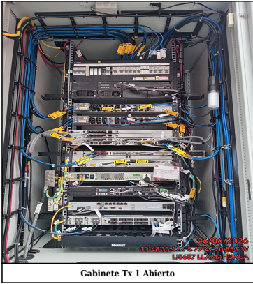
Gabinete Tx 1 Abierto
