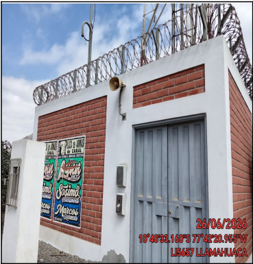
Pozo a tierra
