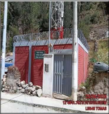
Pozo a tierra
