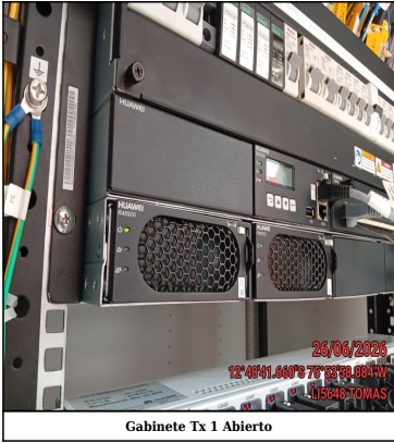
Gabinete Tx 1 Abierto
