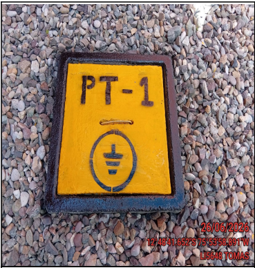
Pozo a tierra
