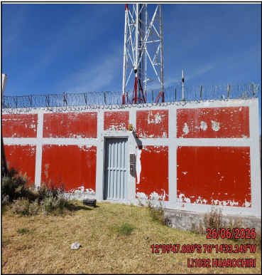
Pozo a tierra
