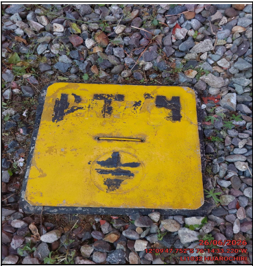
Pozo a tierra
