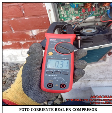
FOTO CORRIENTE REAL EN COMPRESOR
