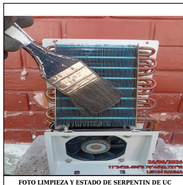
FOTO LIMPIEZA Y ESTADO DE SERPENTIN DE UC
