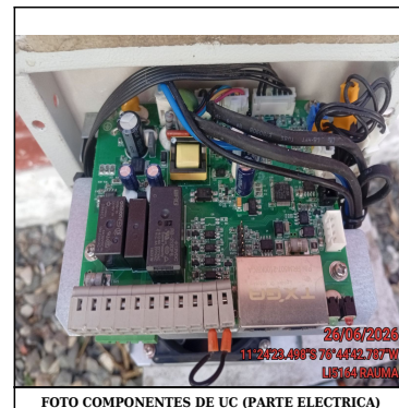
FOTO COMPONENTES DE UC (PARTE ELECTRICA)
