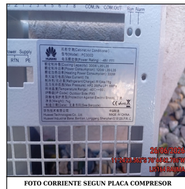
FOTO CORRIENTE SEGUN PLACA COMPRESOR
