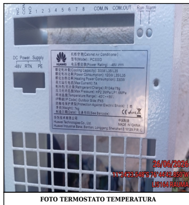
FOTO TERMOSTATO TEMPERATURA
