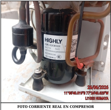
FOTO CORRIENTE REAL EN COMPRESOR
