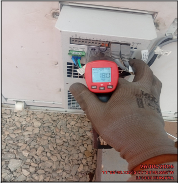
FOTO TEMPERATURA DE EXPULSION
