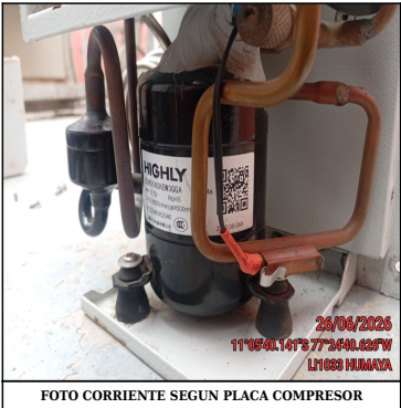
FOTO CORRIENTE SEGUN PLACA COMPRESOR
