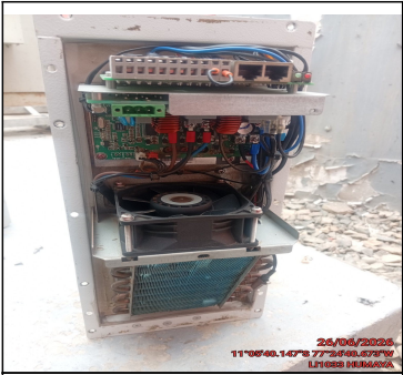
FOTO COMPONENTES DE UC (PARTE ELECTRICA)
