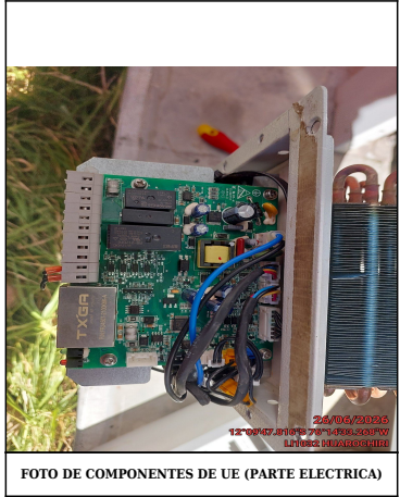
FOTO DE COMPONENTES DE UE (PARTE ELECTRICA)
