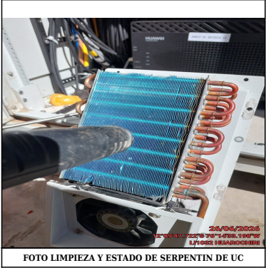
FOTO LIMPIEZA Y ESTADO DE SERPENTIN DE UC
