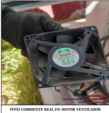
FOTO CORRIENTE REAL EN MOTOR VENTILADOR
