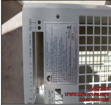
FOTO DE PLACA DE UNIDAD EVAPORADORA
