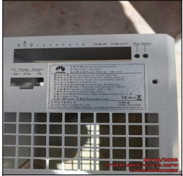
FOTO DE PLACA DE UNIDAD CONDENSADORA
