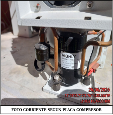
FOTO CORRIENTE SEGUN PLACA COMPRESOR
