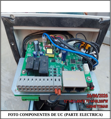
FOTO COMPONENTES DE UC (PARTE ELECTRICA)
