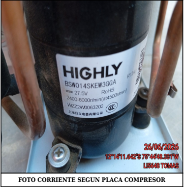
FOTO CORRIENTE SEGUN PLACA COMPRESOR
