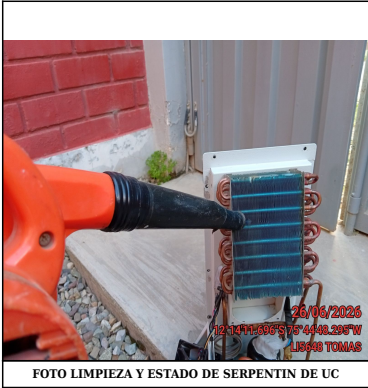
FOTO LIMPIEZA Y ESTADO DE SERPENTIN DE UC
