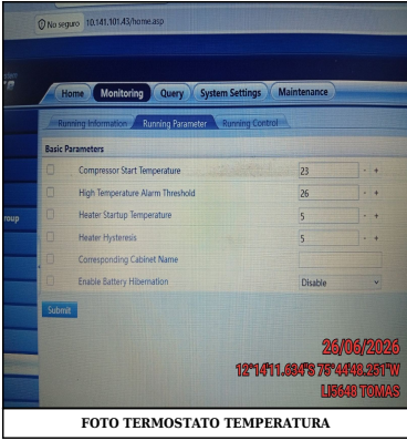
FOTO TERMOSTATO TEMPERATURA
