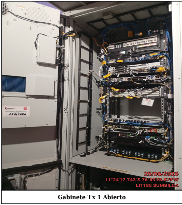
Gabinete Tx 1 Abierto
