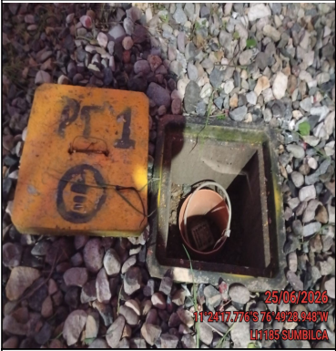
Pozo a tierra
