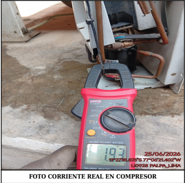
FOTO CORRIENTE REAL EN COMPRESOR
