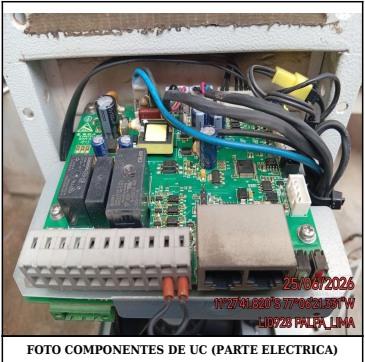
FOTO COMPONENTES DE UC (PARTE ELECTRICA)
