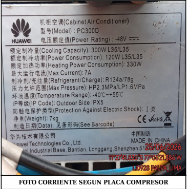
FOTO CORRIENTE SEGUN PLACA COMPRESOR
