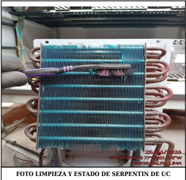
FOTO LIMPIEZA Y ESTADO DE SERPENTIN DE UC
