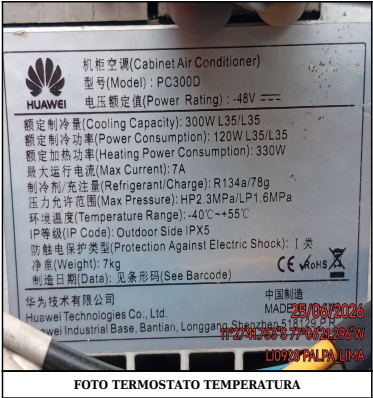
FOTO TERMOSTATO TEMPERATURA
