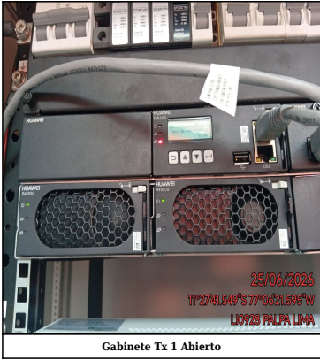
Gabinete Tx 1 Abierto
