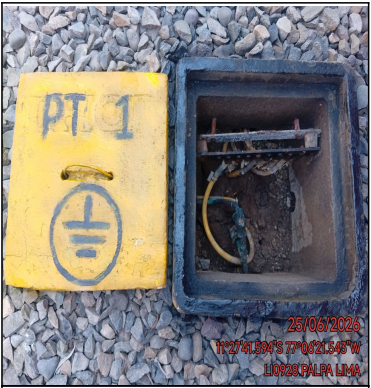
Pozo a tierra
