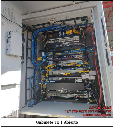
Gabinete Tx 1 Abierto
