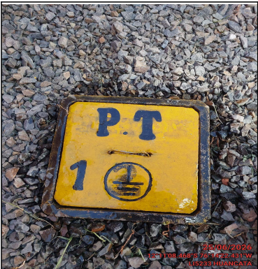
Pozo a tierra
