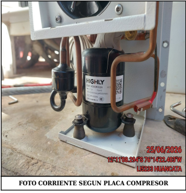
FOTO CORRIENTE SEGUN PLACA COMPRESOR
