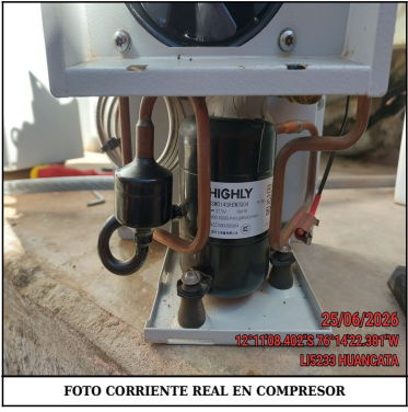
FOTO CORRIENTE REAL EN COMPRESOR
