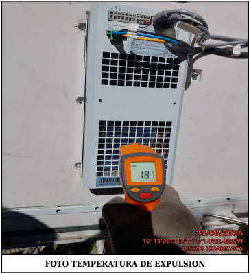
FOTO TEMPERATURA DE EXPULSION
