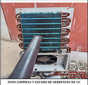
FOTO LIMPIEZA Y ESTADO DE SERPENTIN DE UC
