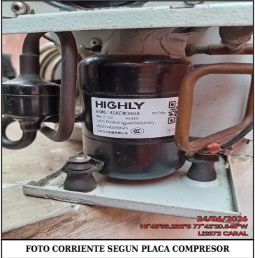
FOTO CORRIENTE SEGUN PLACA COMPRESOR
