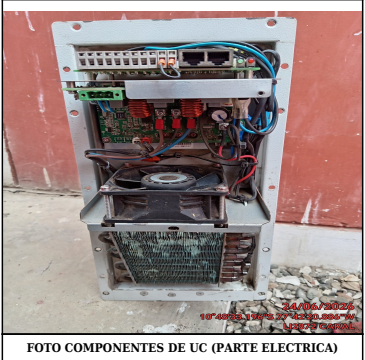
FOTO COMPONENTES DE UC (PARTE ELECTRICA)
