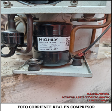
FOTO CORRIENTE REAL EN COMPRESOR
