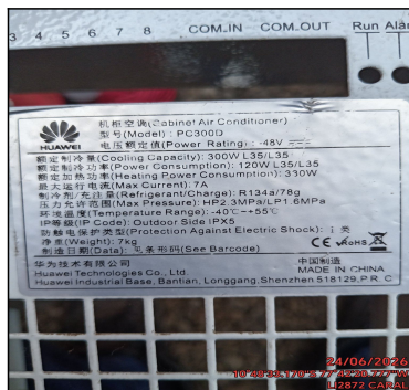
FOTO DE PLACA DE UNIDAD EVAPORADORA
