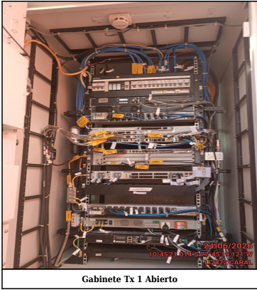
Gabinete Tx 1 Abierto
