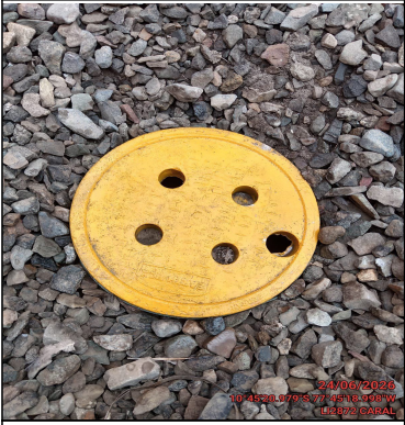
Pozo a tierra
