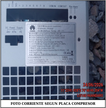
FOTO CORRIENTE SEGUN PLACA COMPRESOR
