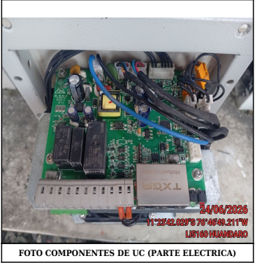
FOTO COMPONENTES DE UC (PARTE ELECTRICA)
