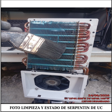
FOTO LIMPIEZA Y ESTADO DE SERPENTIN DE UC
