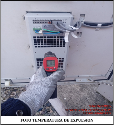
FOTO TEMPERATURA DE EXPULSION
