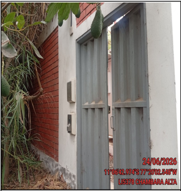
Pozo a tierra
