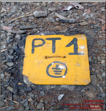
Pozo a tierra
