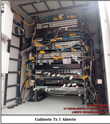
Gabinete Tx 1 Abierto
