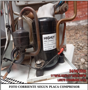
FOTO CORRIENTE SEGUN PLACA COMPRESOR
