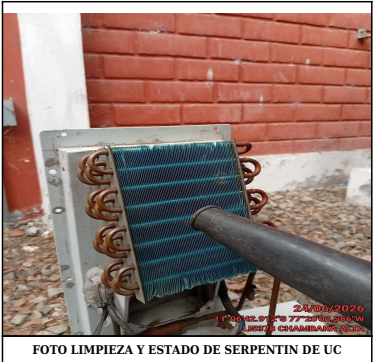
FOTO LIMPIEZA Y ESTADO DE SERPENTIN DE UC
