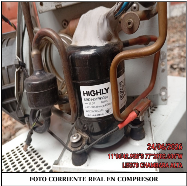
FOTO CORRIENTE REAL EN COMPRESOR
