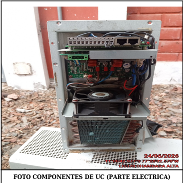
FOTO COMPONENTES DE UC (PARTE ELECTRICA)
