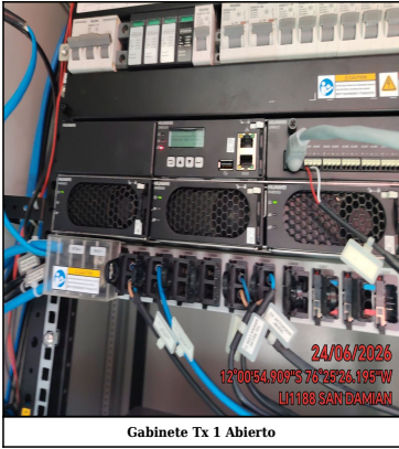
Gabinete Tx 1 Abierto
