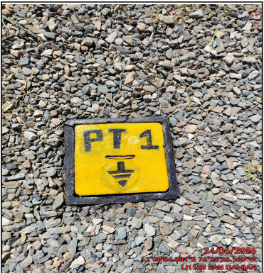
Pozo a tierra
