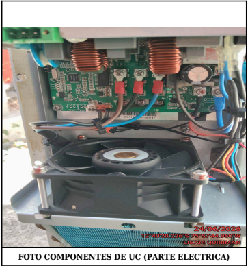
FOTO COMPONENTES DE UC (PARTE ELECTRICA)
