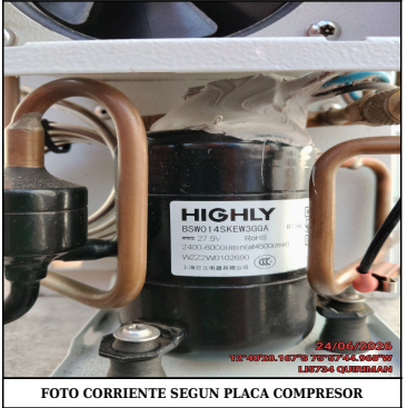
FOTO CORRIENTE SEGUN PLACA COMPRESOR
