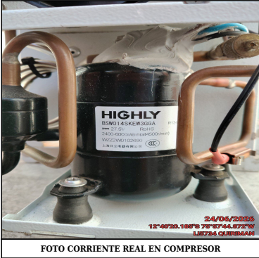
FOTO CORRIENTE REAL EN COMPRESOR
