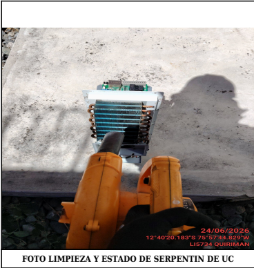
FOTO LIMPIEZA Y ESTADO DE SERPENTIN DE UC
