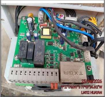
FOTO COMPONENTES DE UC (PARTE ELECTRICA)
