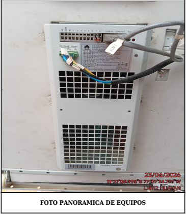
FOTO PANORAMICA DE EQUIPOS
