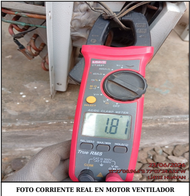
FOTO CORRIENTE REAL EN MOTOR VENTILADOR
