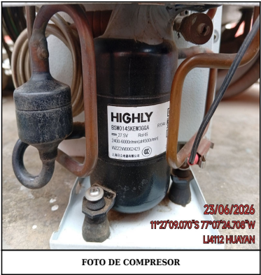
FOTO DE COMPRESOR
