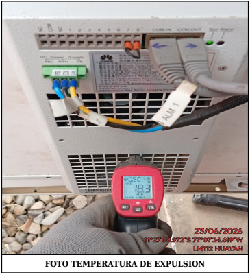
FOTO TEMPERATURA DE EXPULSION
