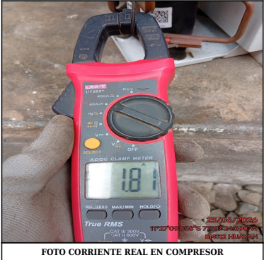
FOTO CORRIENTE REAL EN COMPRESOR
