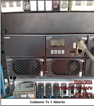
Gabinete Tx 1 Abierto
