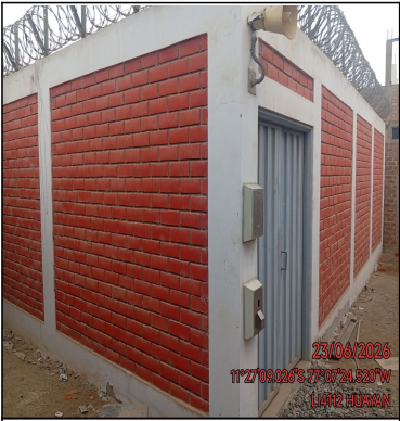
Pozo a tierra
