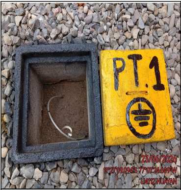
Pozo a tierra
