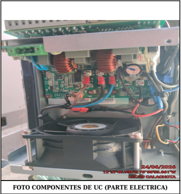
FOTO COMPONENTES DE UC (PARTE ELECTRICA)
