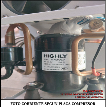
FOTO CORRIENTE SEGUN PLACA COMPRESOR
