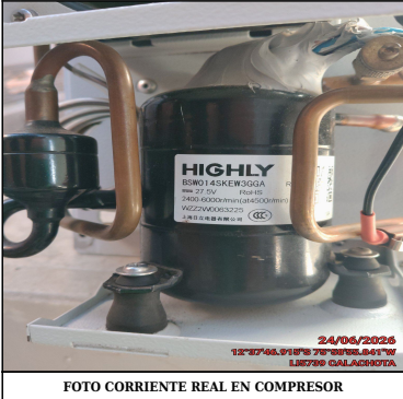
FOTO CORRIENTE REAL EN COMPRESOR
