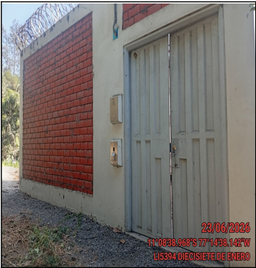
Pozo a tierra
