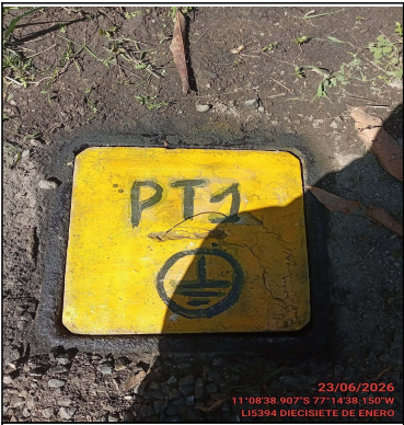
Pozo a tierra
