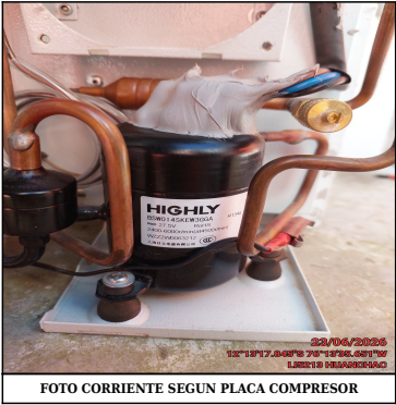
FOTO CORRIENTE SEGUN PLACA COMPRESOR
