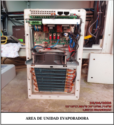
AREA DE UNIDAD EVAPORADORA
