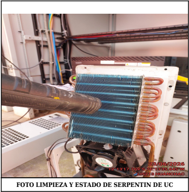
FOTO LIMPIEZA Y ESTADO DE SERPENTIN DE UC
