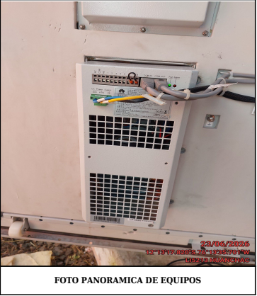
FOTO PANORAMICA DE EQUIPOS
