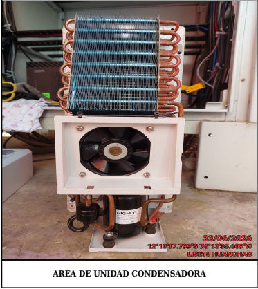
AREA DE UNIDAD CONDENSADORA
