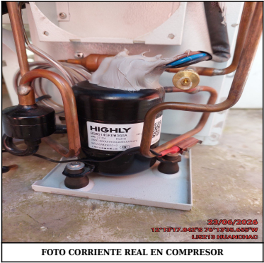
FOTO CORRIENTE REAL EN COMPRESOR
