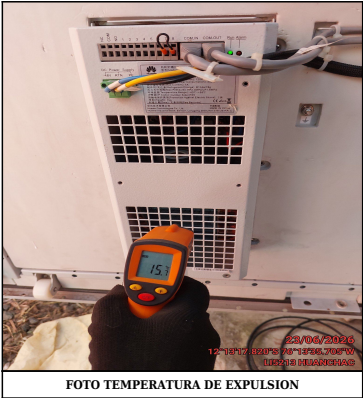
FOTO TEMPERATURA DE EXPULSION
