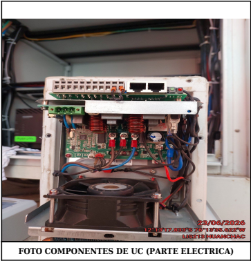
FOTO COMPONENTES DE UC (PARTE ELECTRICA)
