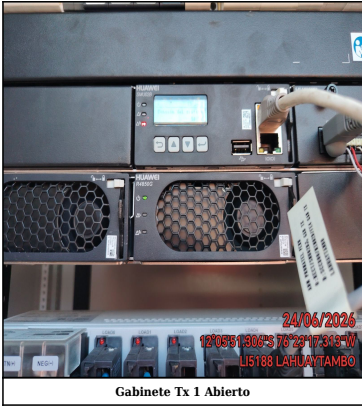
Gabinete Tx 1 Abierto
