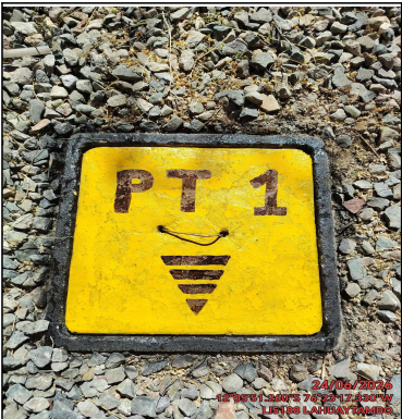
Pozo a tierra
