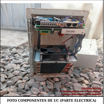
FOTO COMPONENTES DE UC (PARTE ELECTRICA)
