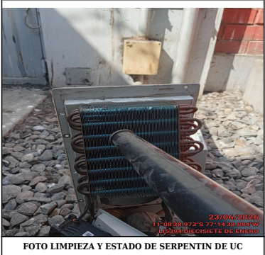
FOTO LIMPIEZA Y ESTADO DE SERPENTIN DE UC
