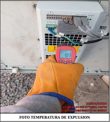
FOTO TEMPERATURA DE EXPULSION
