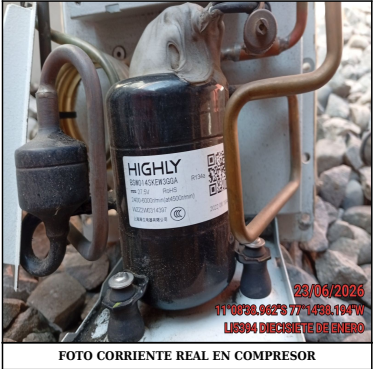
FOTO CORRIENTE REAL EN COMPRESOR
