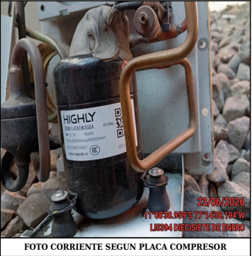
FOTO CORRIENTE SEGUN PLACA COMPRESOR
