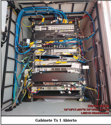
Gabinete Tx 1 Abierto
