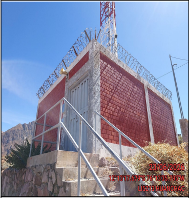
Pozo a tierra
