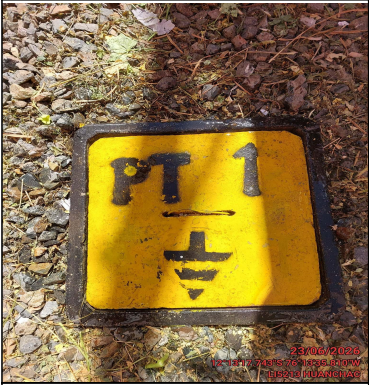
Pozo a tierra
