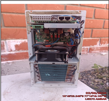
FOTO COMPONENTES DE UC (PARTE ELECTRICA)
