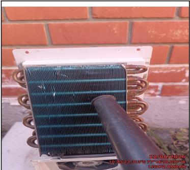
FOTO LIMPIEZA Y ESTADO DE SERPENTIN DE UC
