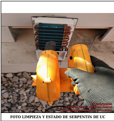
FOTO LIMPIEZA Y ESTADO DE SERPENTIN DE UC
