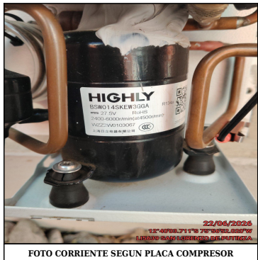
FOTO CORRIENTE SEGUN PLACA COMPRESOR
