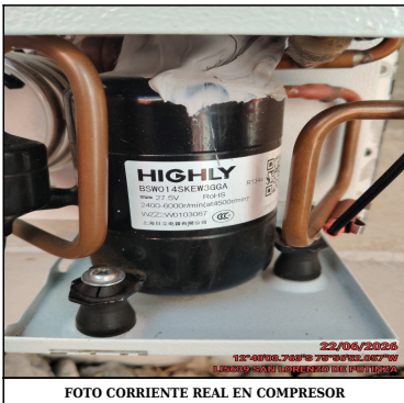
FOTO CORRIENTE REAL EN COMPRESOR
