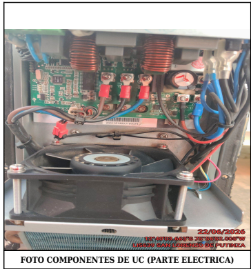
FOTO COMPONENTES DE UC (PARTE ELECTRICA)
