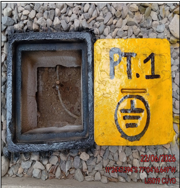
Pozo a tierra
