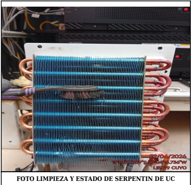
FOTO LIMPIEZA Y ESTADO DE SERPENTIN DE UC
