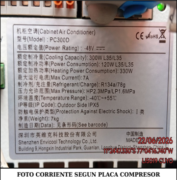
FOTO CORRIENTE SEGUN PLACA COMPRESOR
