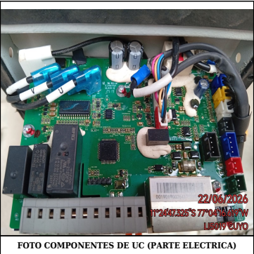
FOTO COMPONENTES DE UC (PARTE ELECTRICA)
