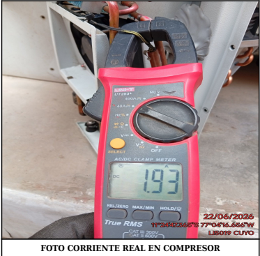
FOTO CORRIENTE REAL EN COMPRESOR
