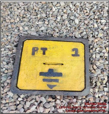
Pozo a tierra
