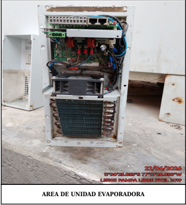
AREA DE UNIDAD EVAPORADORA
