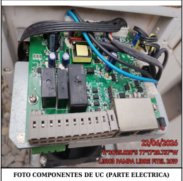
FOTO COMPONENTES DE UC (PARTE ELECTRICA)
