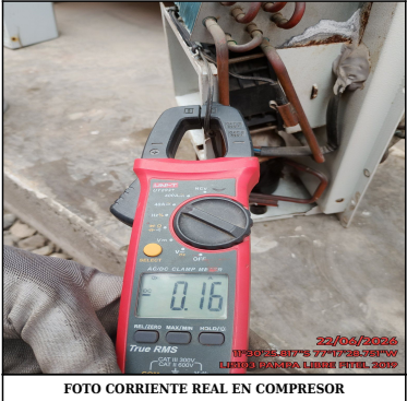
FOTO CORRIENTE REAL EN COMPRESOR
