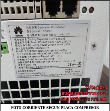
FOTO CORRIENTE SEGUN PLACA COMPRESOR
