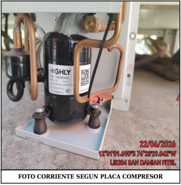
FOTO CORRIENTE SEGUN PLACA COMPRESOR
