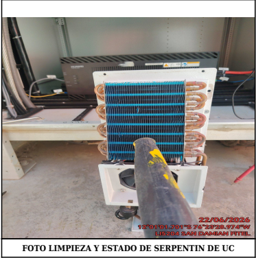
FOTO LIMPIEZA Y ESTADO DE SERPENTIN DE UC
