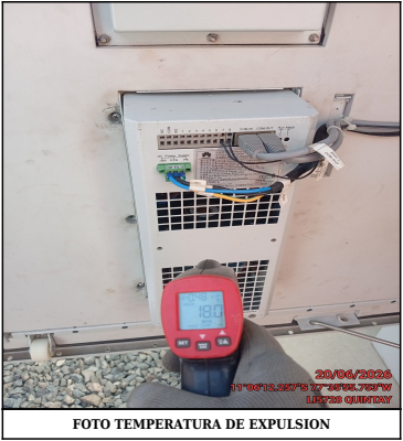
FOTO TEMPERATURA DE EXPULSION
