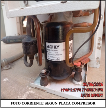
FOTO CORRIENTE SEGUN PLACA COMPRESOR
