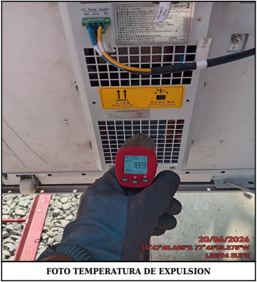
FOTO TEMPERATURA DE EXPULSION
