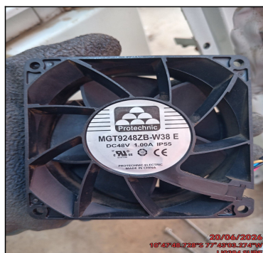
FOTO CORRIENTE REAL EN MOTOR VENTILADOR
