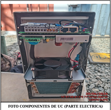
FOTO COMPONENTES DE UC (PARTE ELECTRICA)
