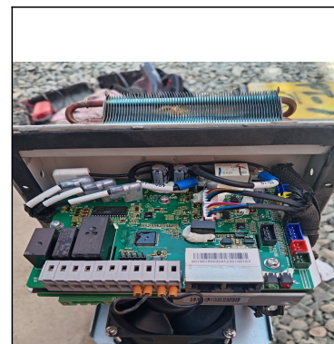
FOTO DE COMPONENTES DE UE (PARTE ELECTRICA)
