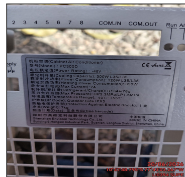
FOTO DE PLACA DE UNIDAD CONDENSADORA
