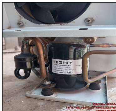
FOTO DE COMPRESOR
