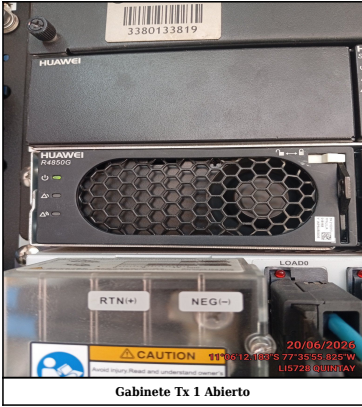
Gabinete Tx 1 Abierto
