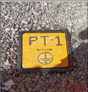
Pozo a tierra
