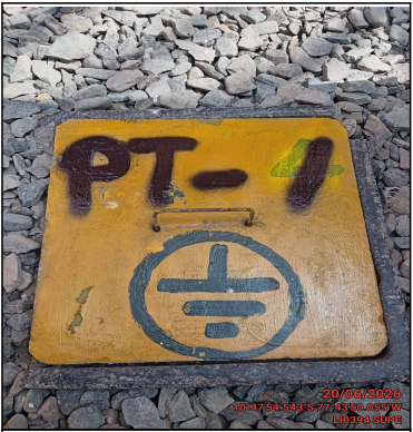
Pozo a tierra
