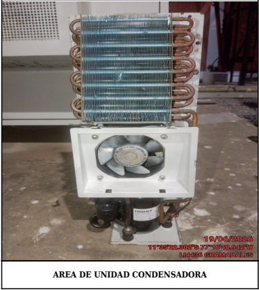
AREA DE UNIDAD CONDENSADORA
