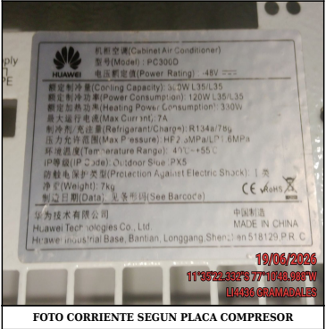
FOTO CORRIENTE SEGUN PLACA COMPRESOR
