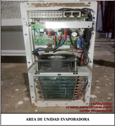
AREA DE UNIDAD EVAPORADORA
