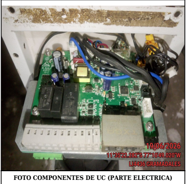
FOTO COMPONENTES DE UC (PARTE ELECTRICA)
