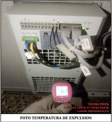
FOTO TEMPERATURA DE EXPULSION
