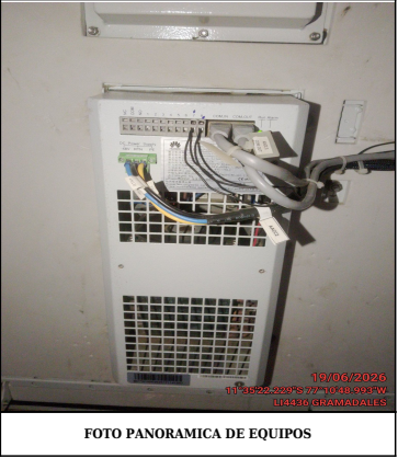
FOTO PANORAMICA DE EQUIPOS
