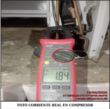
FOTO CORRIENTE REAL EN COMPRESOR
