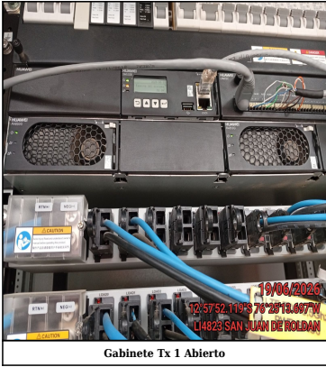
Gabinete Tx 1 Abierto
