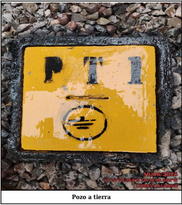
Pozo a tierra
