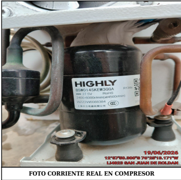
FOTO CORRIENTE REAL EN COMPRESOR
