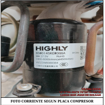
FOTO CORRIENTE SEGUN PLACA COMPRESOR
