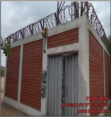
Pozo a tierra
