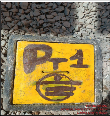
Pozo a tierra
