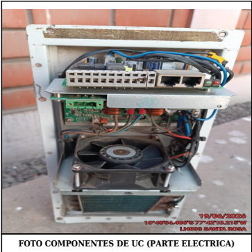
FOTO COMPONENTES DE UC (PARTE ELECTRICA)
