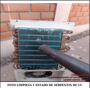
FOTO LIMPIEZA Y ESTADO DE SERPENTIN DE UC
