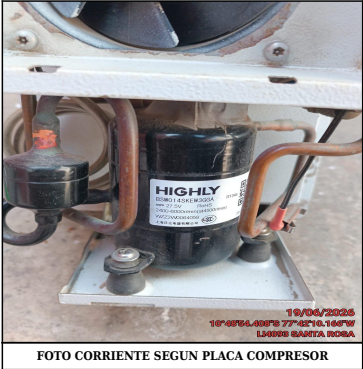
FOTO CORRIENTE SEGUN PLACA COMPRESOR
