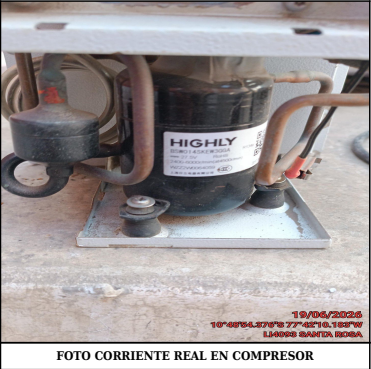
FOTO CORRIENTE REAL EN COMPRESOR
