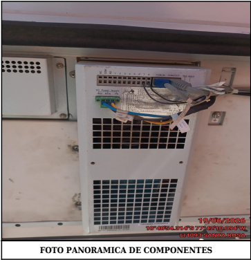
FOTO PANORAMICA DE COMPONENTES
