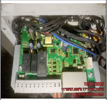
FOTO COMPONENTES DE UC (PARTE ELECTRICA)
