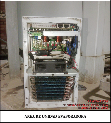
AREA DE UNIDAD EVAPORADORA
