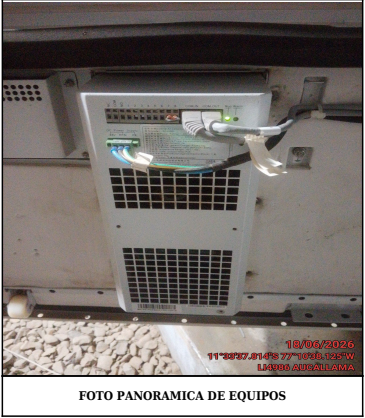
FOTO PANORAMICA DE EQUIPOS
