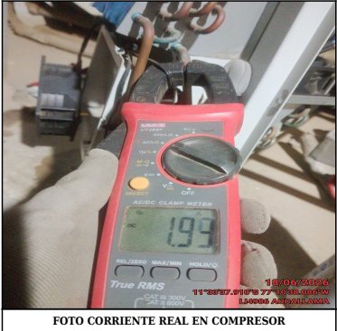
FOTO CORRIENTE REAL EN COMPRESOR
