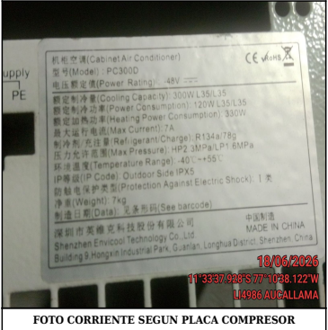
FOTO CORRIENTE SEGUN PLACA COMPRESOR
