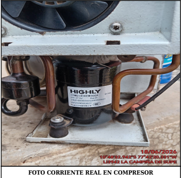
FOTO CORRIENTE REAL EN COMPRESOR
