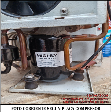
FOTO CORRIENTE SEGUN PLACA COMPRESOR
