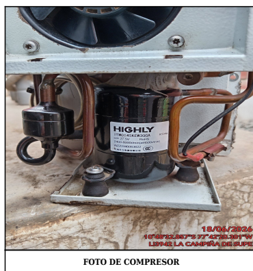
FOTO DE COMPRESOR
