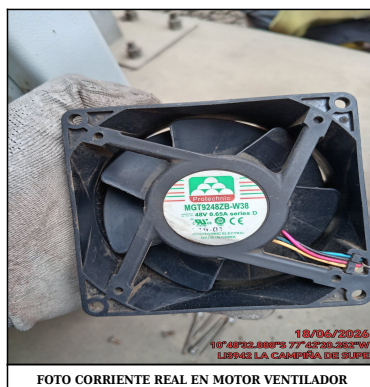
FOTO CORRIENTE REAL EN MOTOR VENTILADOR
