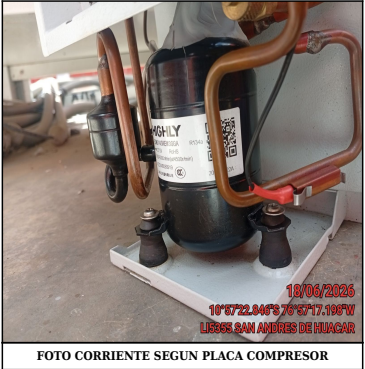
FOTO CORRIENTE SEGUN PLACA COMPRESOR
