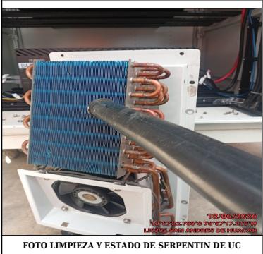
FOTO LIMPIEZA Y ESTADO DE SERPENTIN DE UC
