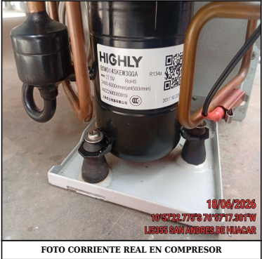
FOTO CORRIENTE REAL EN COMPRESOR
