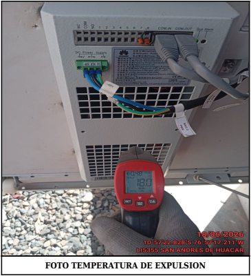
FOTO TEMPERATURA DE EXPULSION
