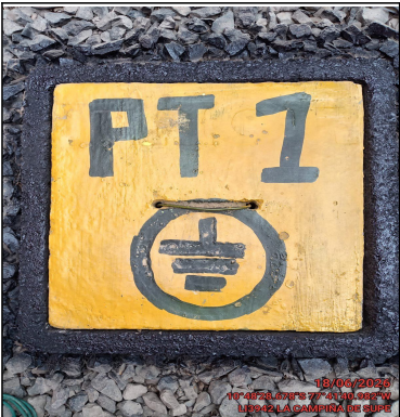
Pozo a tierra
