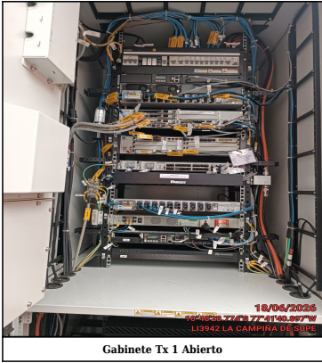
Gabinete Tx 1 Abierto
