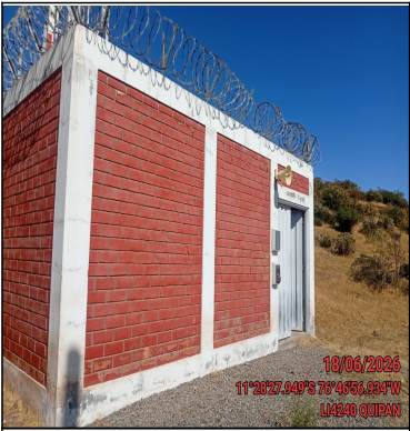
Pozo a tierra
