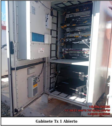
Gabinete Tx 1 Abierto
